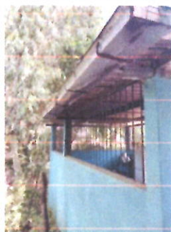
CANAL, SUSTITUCION DE CANAL EN MAL ESTADO
